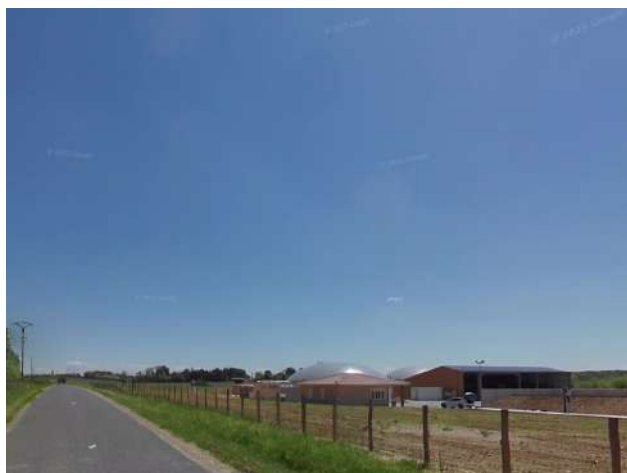
Le méthaniseur de Rignieux-le-Franc en cours de construction le long de la route de Meximieux. L'accompagnement végétal est encore peu présent et pourra être renforcé.
